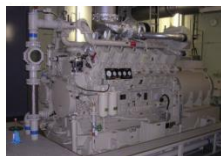
非常用発電設備
